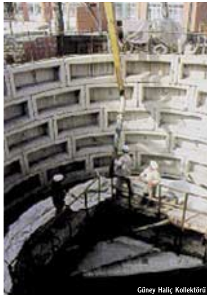
Güney Haliç Kolektörü
