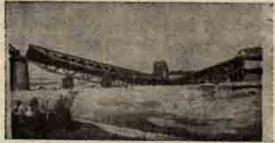
ŞEKİL : 9 Hindistan'da 1934 Bihar depremi sırasında bir demiryolu köprüsünün çöküşü.
